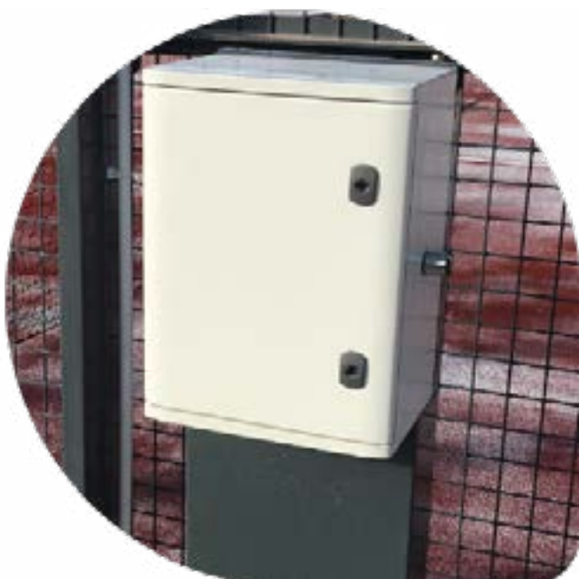
Armoire sur pied avec disjoncteurs, contacteur à clé, et protège câble, tôle acier.
