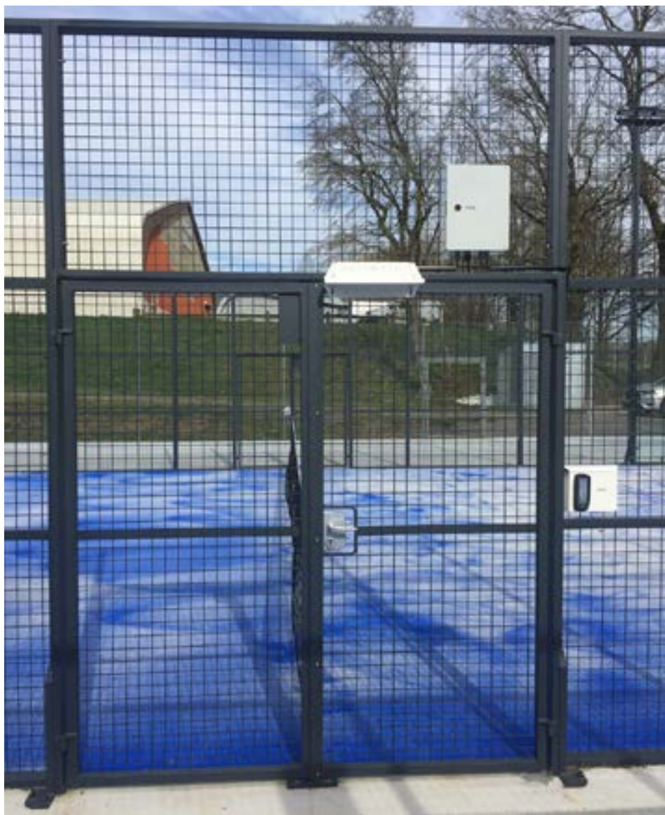
Contrôle d'accès Padel
